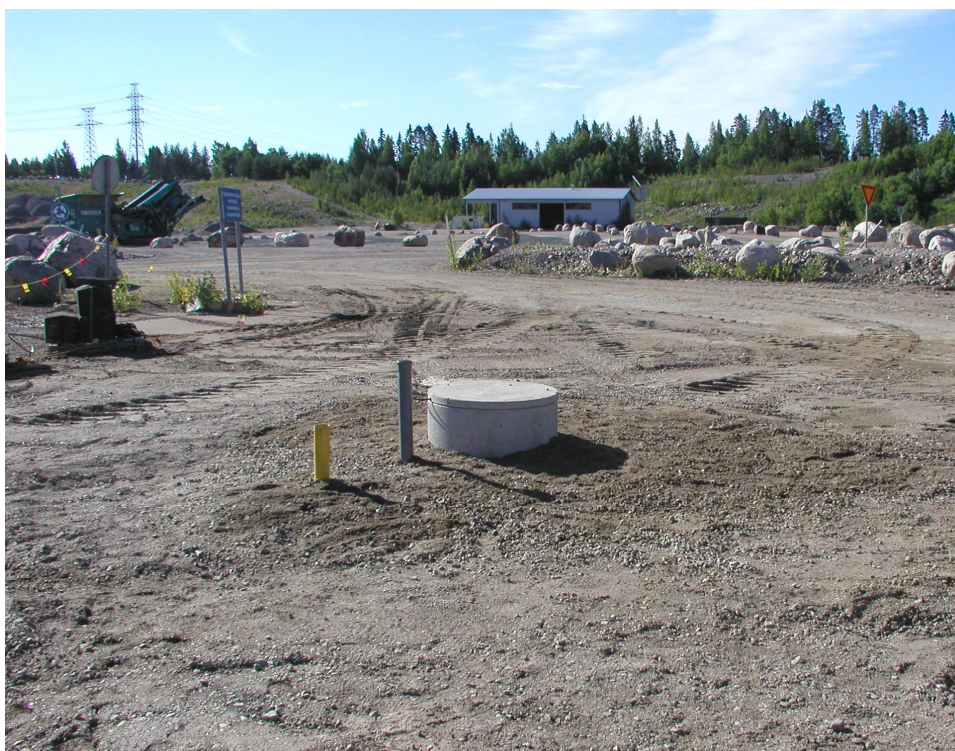
Kuva 2. Säiliö upotuskokeessa (saostussäilön huoltokaivon päällä 0,5 m:n korkuinen betonirengas).
